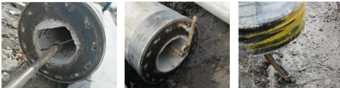
图 6.3.2-1 注浆管侧向固定 图 6.3.2-2 注浆管顶端固定 图 6.3.2-3 注浆管外露易折
